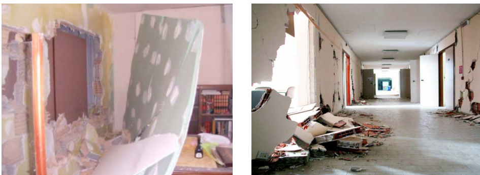
Figura 6.2. Esempi di partizioni interne danneggiati dal sisma
