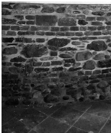
Figura 8.2. Presenza massiccia di umidità sulle pareti interne
