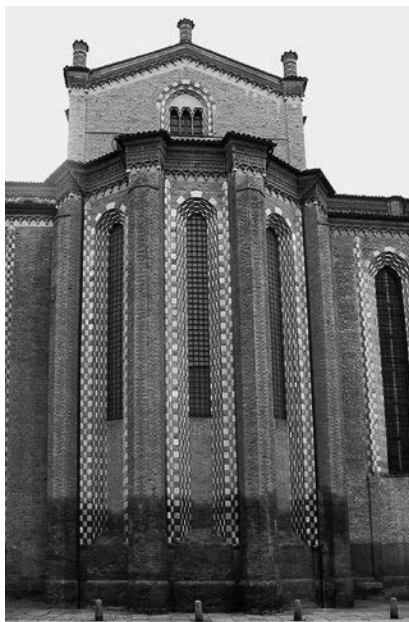
Figura 2.1. Cattedrale di Asti, prospetto Sud. Demarcazione del fronte di risalita
