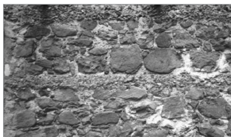
Presenza di ricorsi in conglomerato cementizio.
