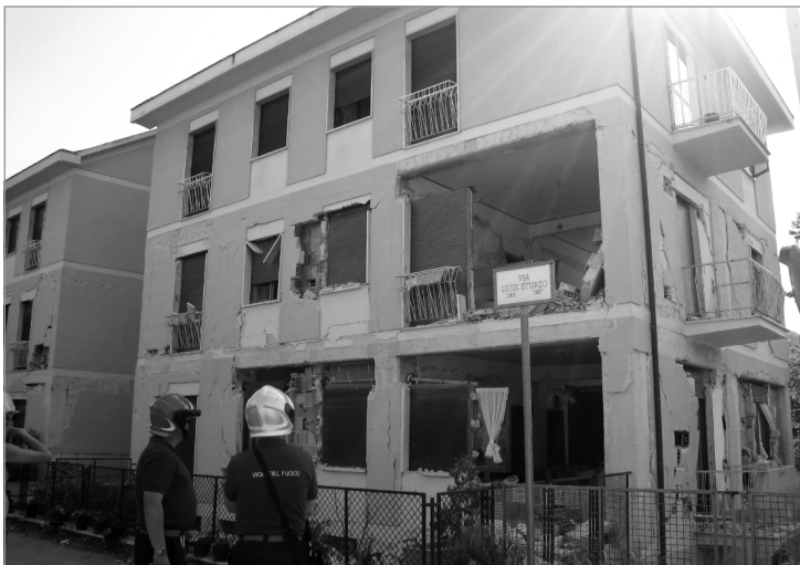
Figura 12.1. Espulsione di pannelli di tamponamento (terremoto de L'Aquila, 2009 – Foto Arch. Roberto Amabilia)
