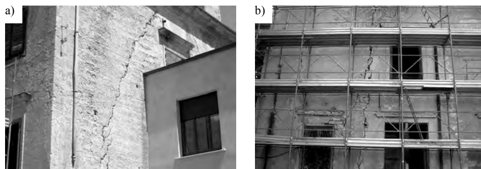
Figura 2.10. Villa Rose – Lercara: lesione a) ad andamento curvilineo; b) ad andamento verticale.
