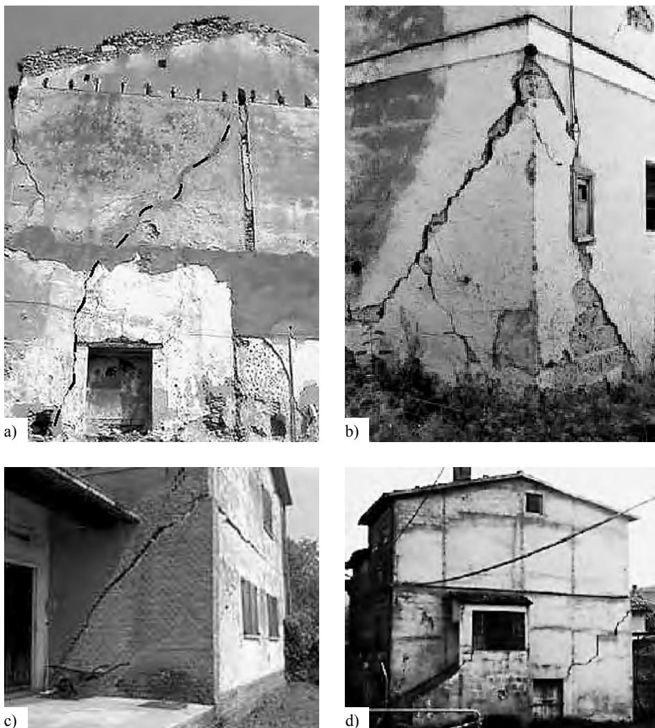
Figura 1.4. Lesioni sui prospetti causate da cedimenti fondali: a) zona centrale; b, d) cantonali; c) lungo tutta una parete.
