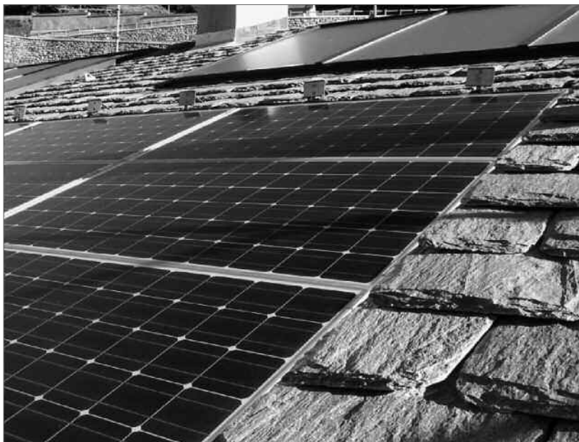
Esempio di impianto fotovoltaico totalmente integrato
